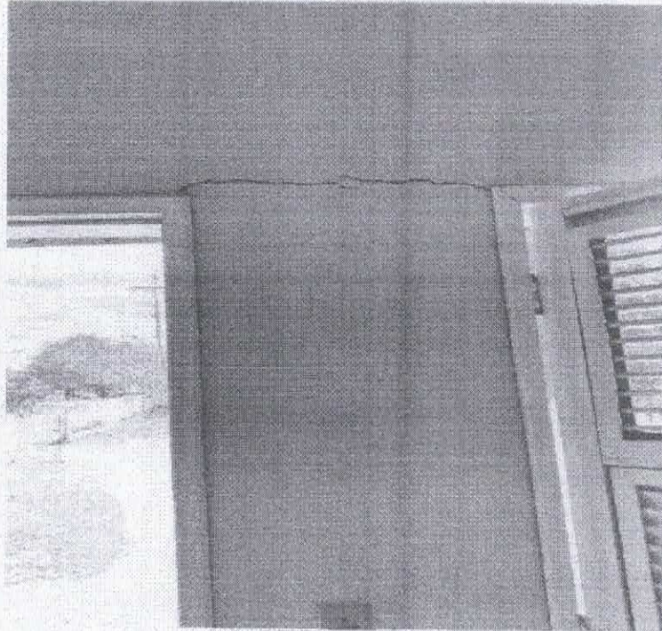
Figura 3 – ALVENARIA COM RACHADURA
