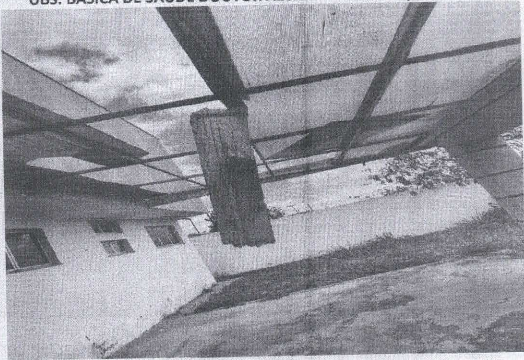
Figura 5 – CHAPA DE POLICARBONATO - DANIFICADA
