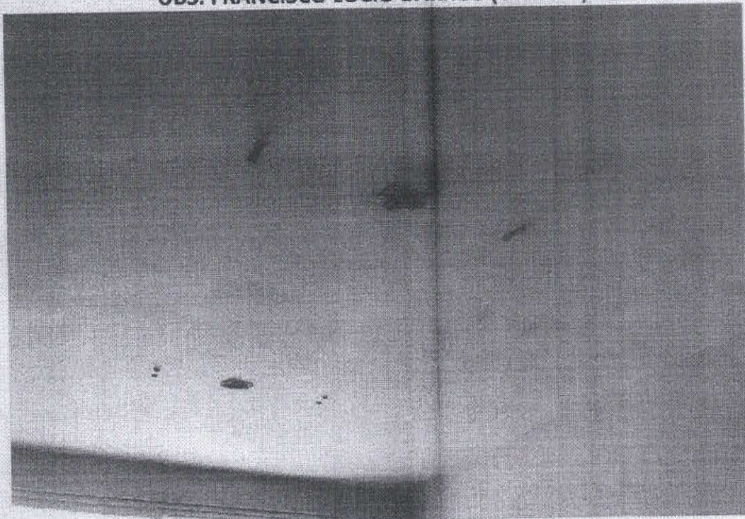
Figura 9 - FALTA DE LUMINÁRIAS
