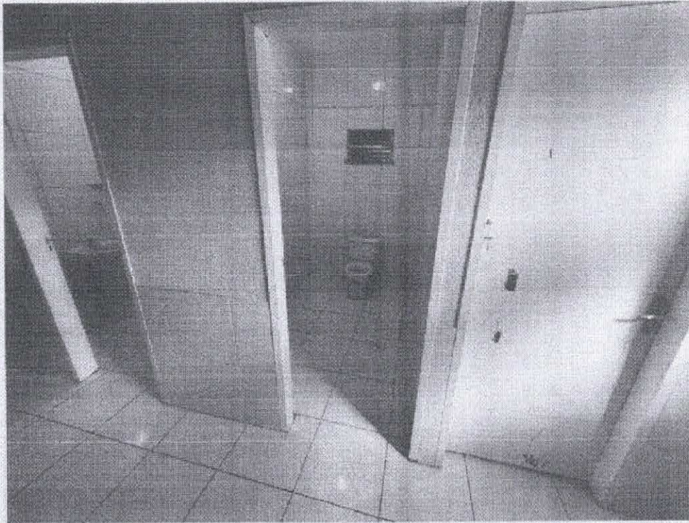
Figura 5 – PORTA DANIFICADA / BANHEIRO SEM PORTA
