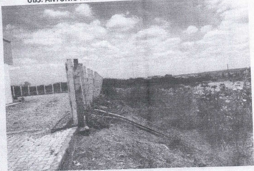
Figura 11 – CERCA DE PROTEÇÃO – DANIFICADA
