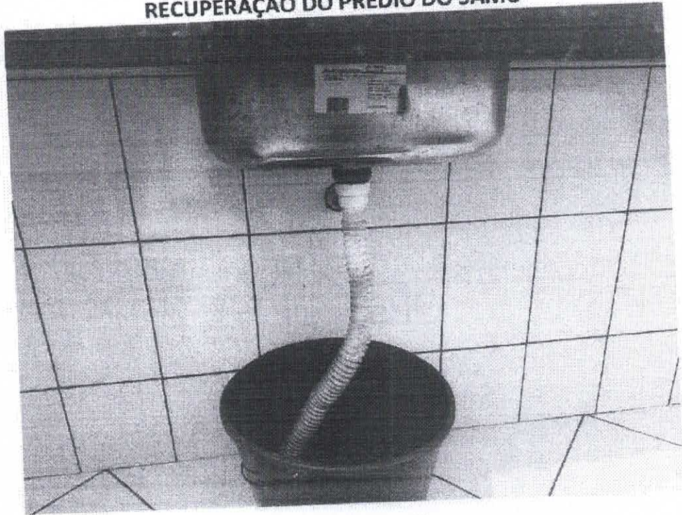
Figura 5 - SIFÃO PIA COZINHA
