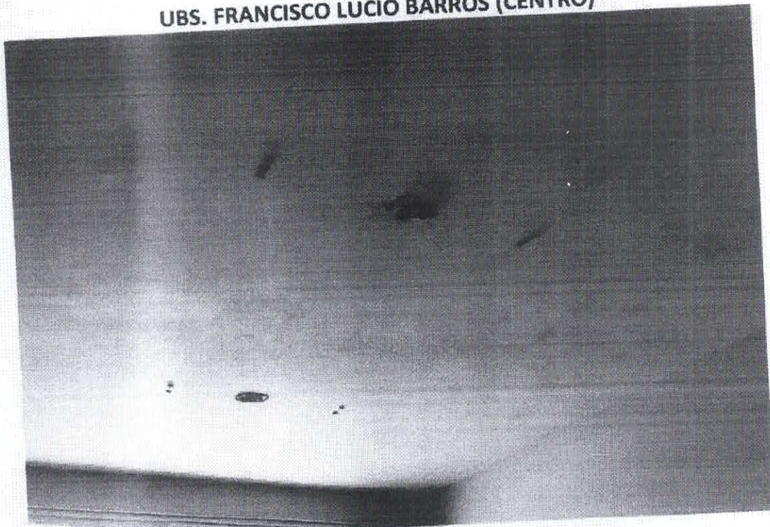
Figura 9 – FALTA DE LUMINÁRIAS
