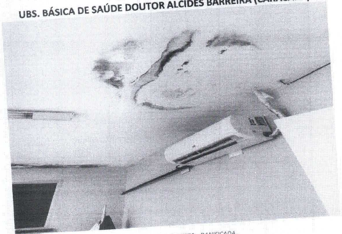
Figura 7 – PINTURA TETO – DANIFICADA.
