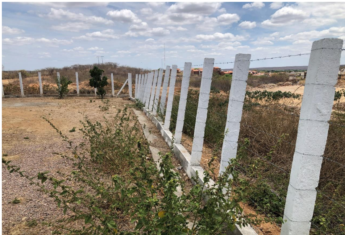
Figura 12 – CERCA DE PROTEÇÃO – DANIFICADA
