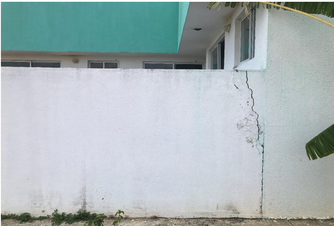
Figura 6 – ALVENARIA – COM RACHADURA
