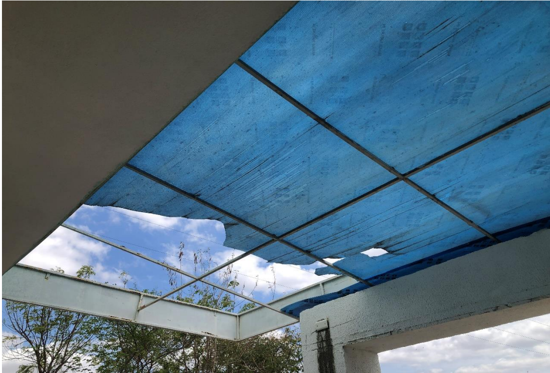
Figura 5 – CHAPA DE POLICARBONATO - DANIFICADA
