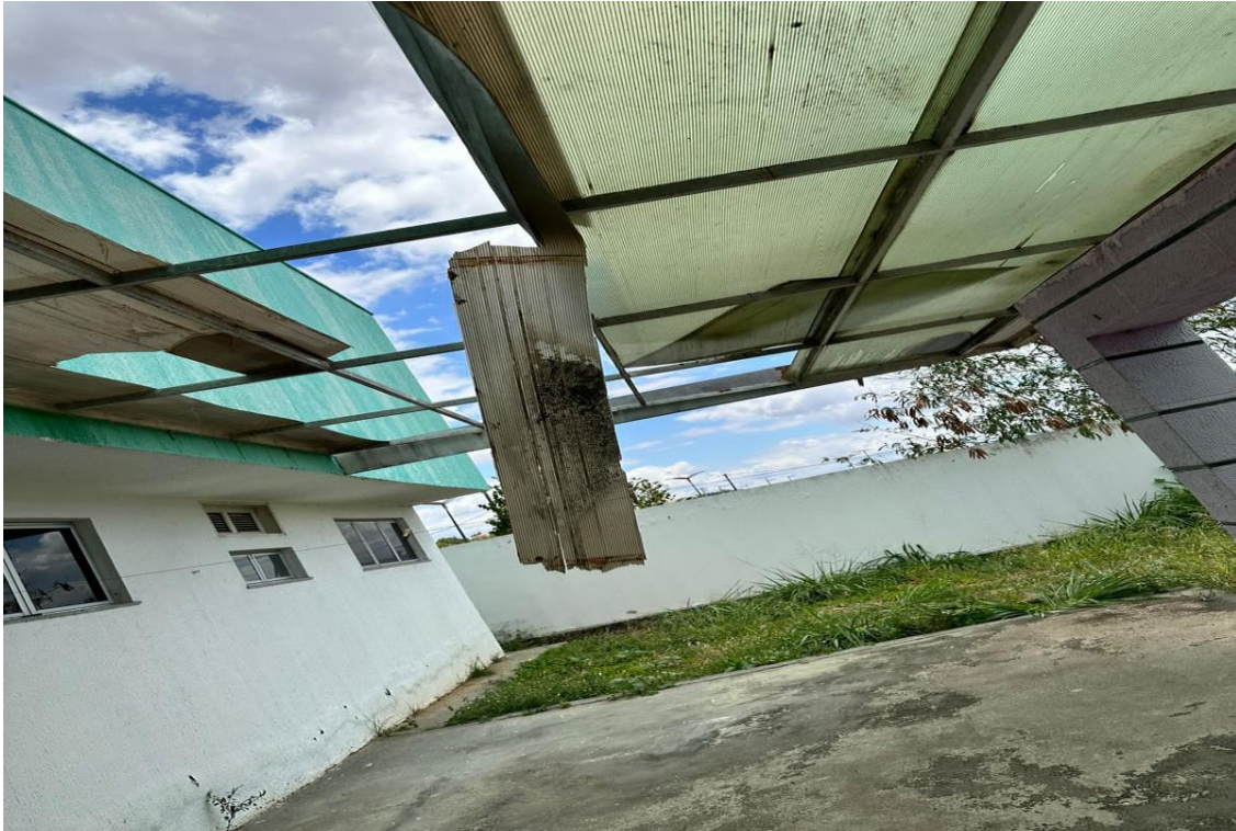
Figura 5 – CHAPA DE POLICARBONATO - DANIFICADA
