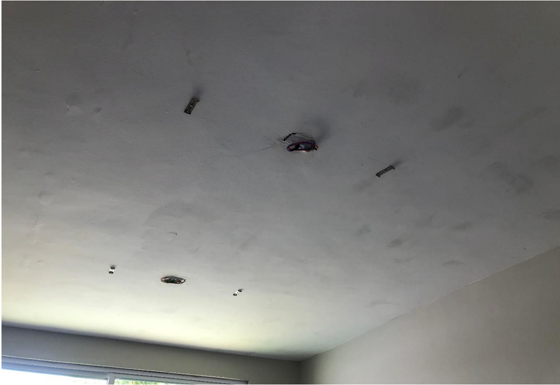
Figura 9 – FALTA DE LUMINÁRIAS
