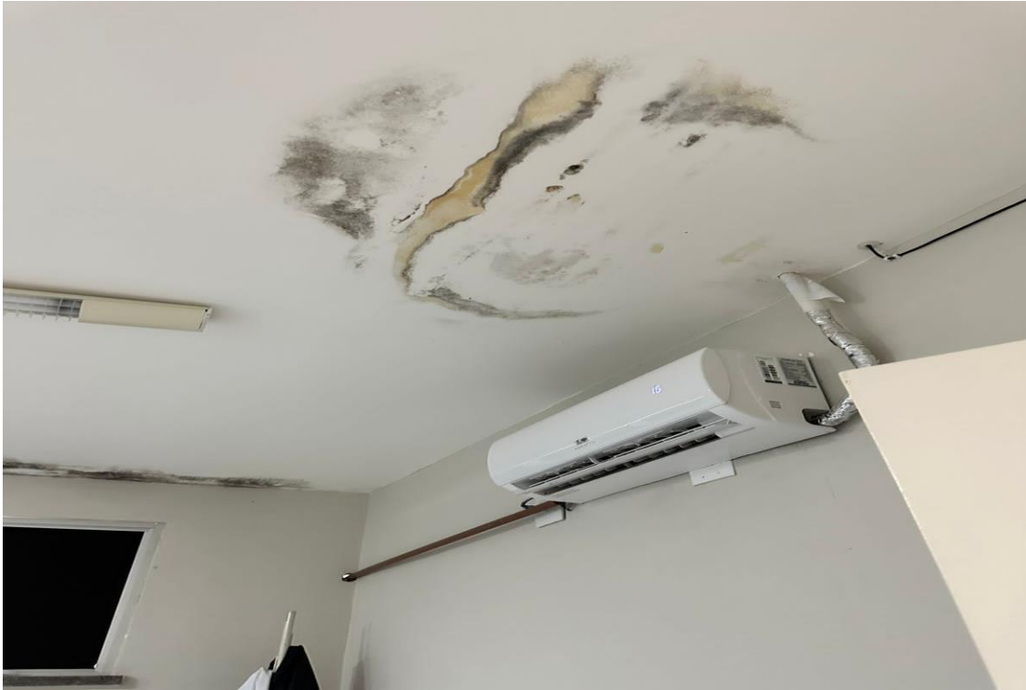
Figura 7 – PINTURA TETO - DANIFICADA
