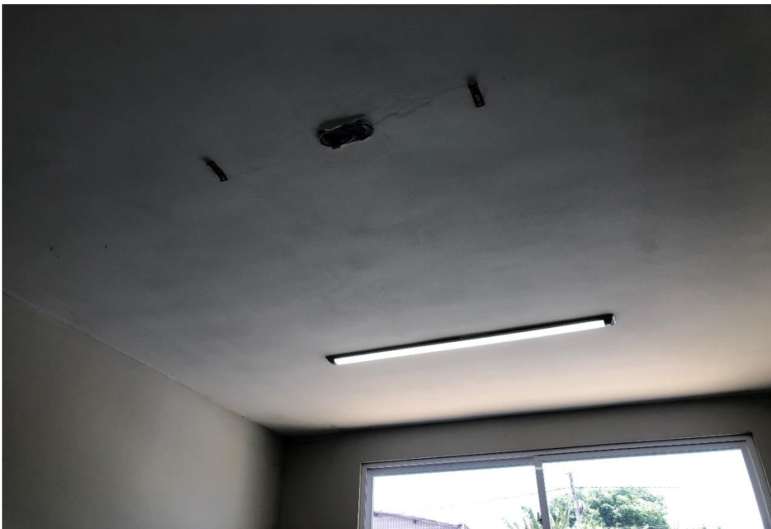
Figura 10 – FALTA DE LUMINÁRIAS
