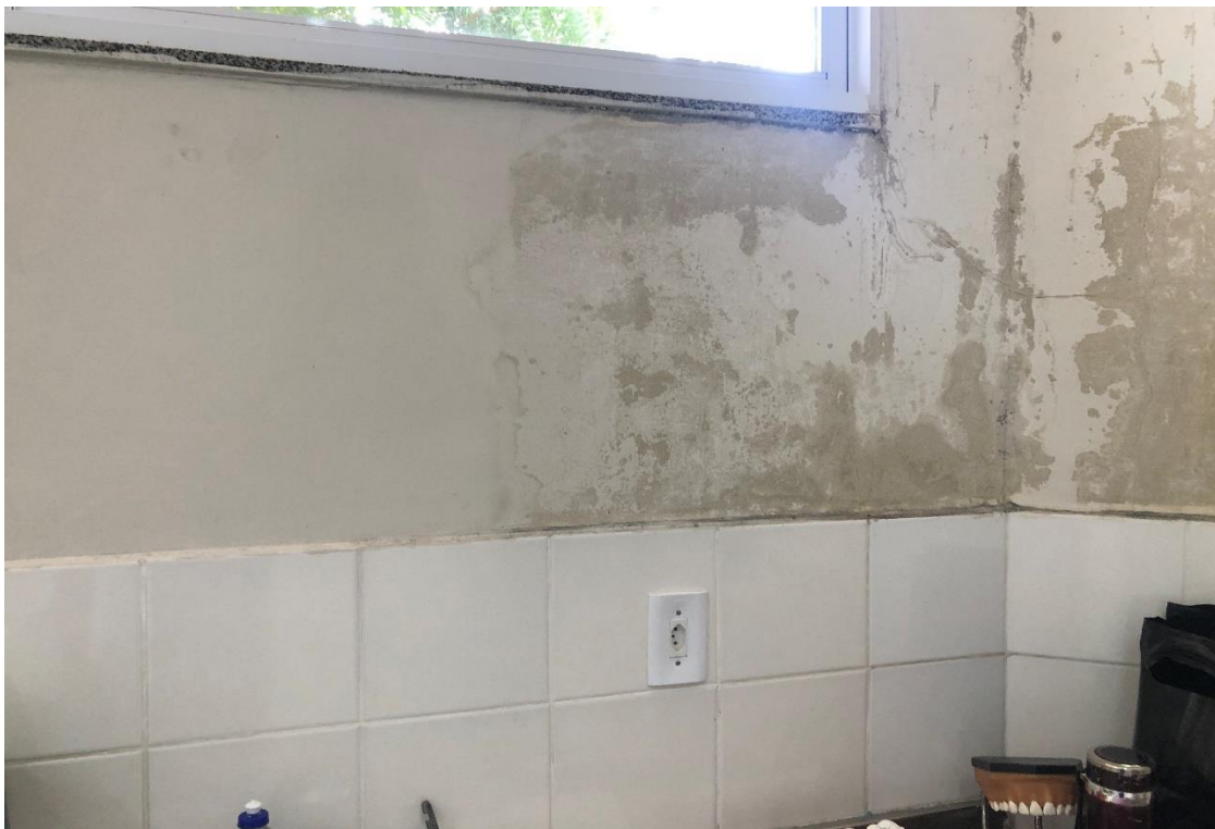
Figura 8 – PINTURA DANIFICADA – CONSULTÓRIO ODONTOLÓGICO
