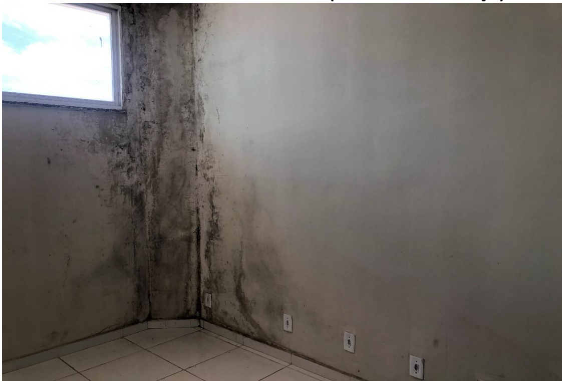
Figura 9 – PINTURA DANIFICADA – SALA DE PROCEDIMENTOS
