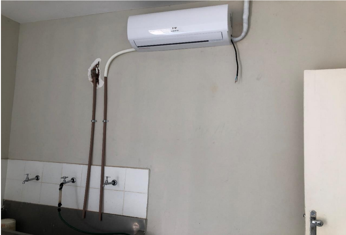
Figura 7 – AR-CONDICIONADO – INSTALAÇÃO E DRENOS
