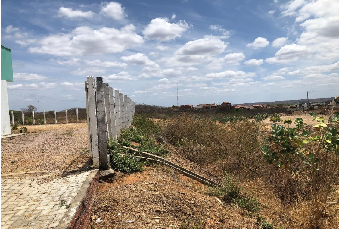
Figura 11 – CERCA DE PROTEÇÃO – DANIFICADA
