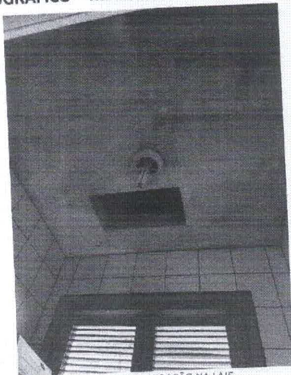
Figura 5 – INFILTRAÇÃO NA LAJE
