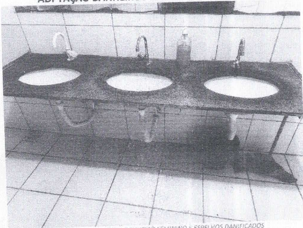
Figura 5 - BANCADA BANHEIRO FEMININO E ESPELHOS DANIFICADOS
